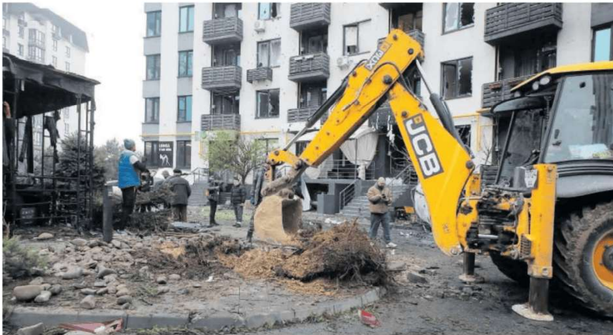
Una excavadora repara una urbanización dañada por un ataque ruso en Kiev, el 29 de noviembre de 2025. UKRINFORM (NURPHOTO / GETTY IMAGES)
